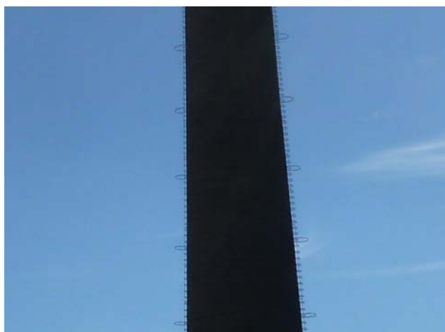
Foto 2: Detail kovových žebříků ze severovýchodu
